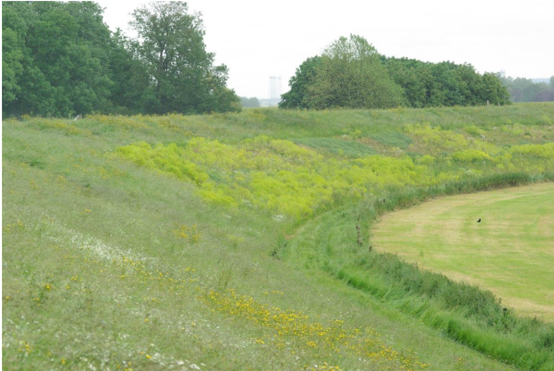
Afbeelding 2.8 Impressies dijktraject, foto 1 met zicht op buitendijks gebied ter hoogte van dijksectie 14, foto 2 met zicht op buitendijks gebied ter hoogte van dijksectie 10
